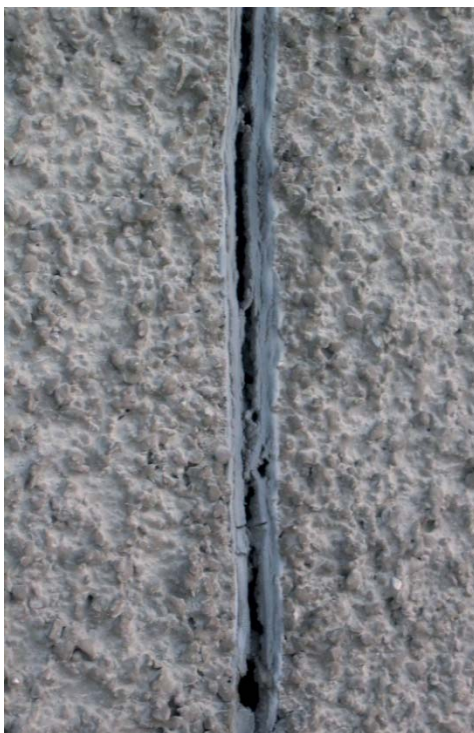
Sprucken fogmassa mellan fasadelement av betong
